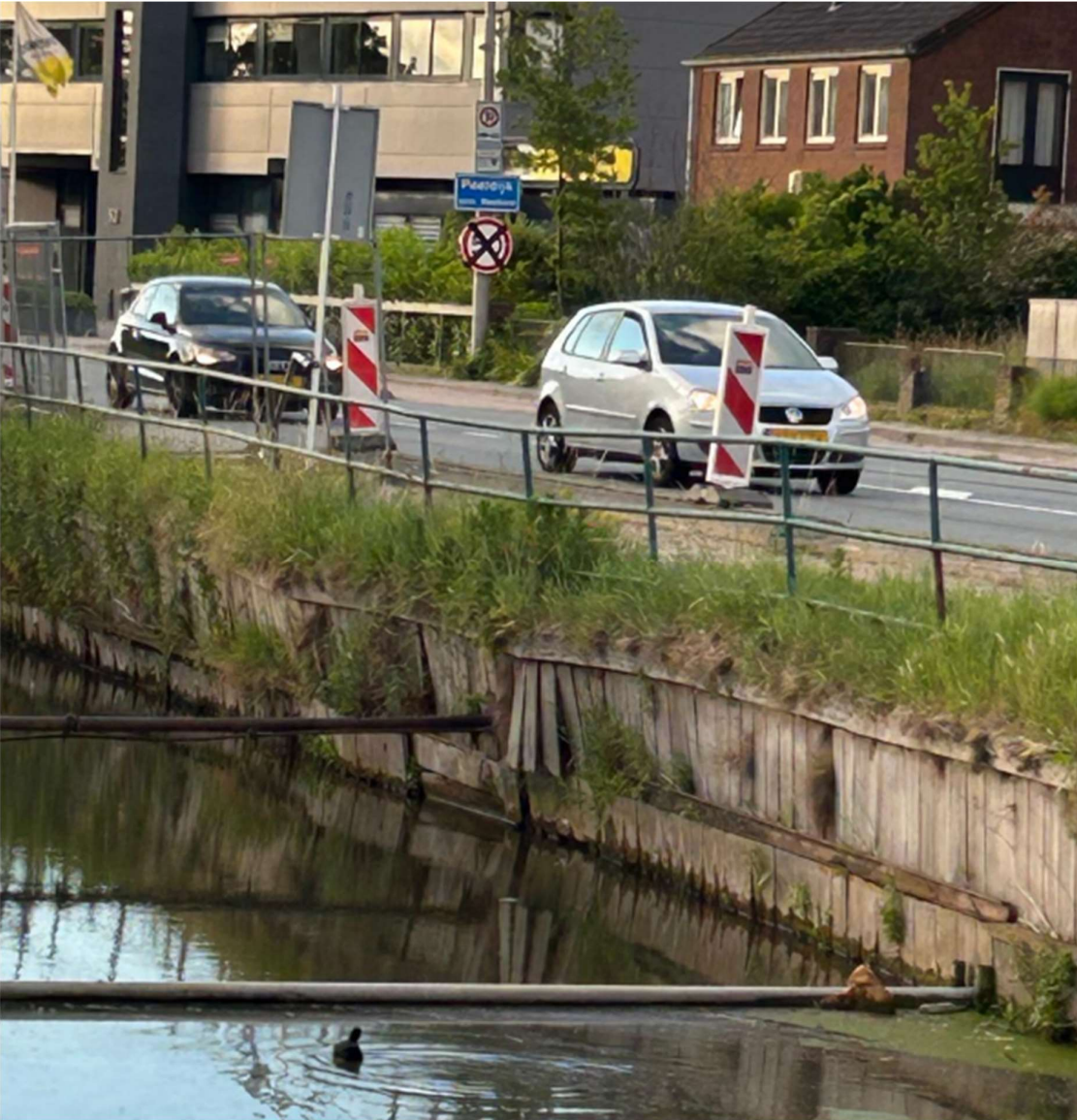
De damwandconstructie die op instorten staat
